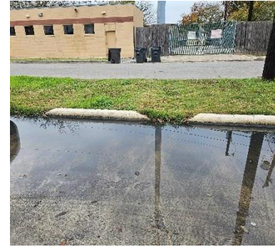
Figura 15: La eliminación del lodo es necesaria para permitir que las aguas pluviales entren en el área del césped.
