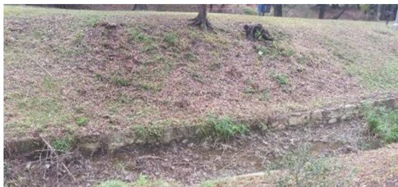
Figura 5: Las pendientes presentan un desafío; esta vegetación ha sido cortada demasiado corta, incrementando la erosión del suelo y permitiendo que crezcan las malas hierbas.
