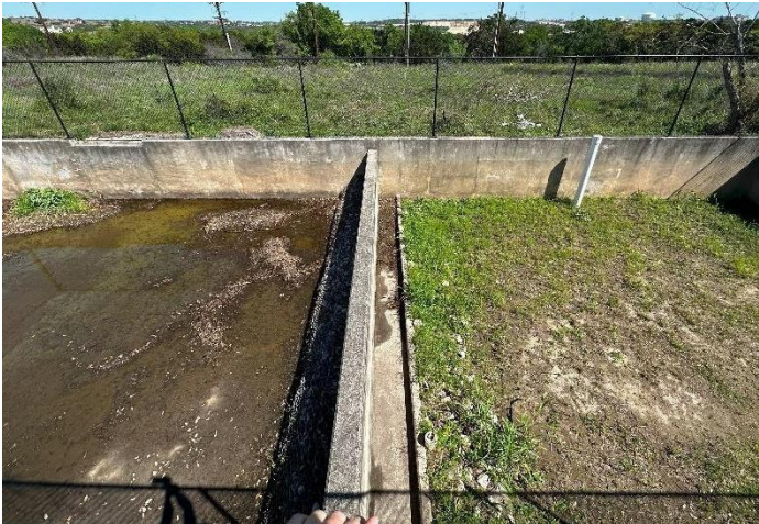
Figura 19: El agua estancada indica el mantenimiento necesario para una filtración adecuada, que incluiría la eliminación de sedimentos.
